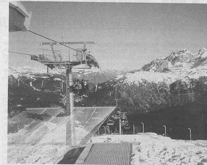
Gli impianti della Spa Funvie di Pinzolo
